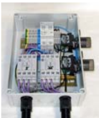
Bilde viser kontaktorskapp for 14 kW
