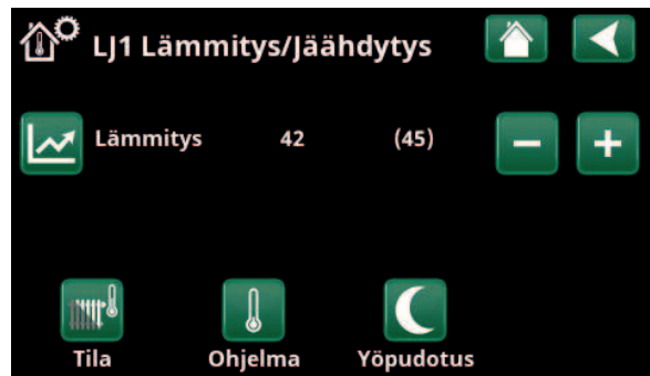
Valikko "Edistysellinen/Määrittele/Lämmitysjärjestelmä/LJ1". Lämmitysjärjestelmässä ei ole huoneantureita. Asetuspiste (menoveden lämpötila 45\text{ }^{\circ}\text{C} ) näkyy suluissa, nykyinen menoveden lämpötila 42\text{ }^{\circ}\text{C} näkyy asetuspisteen vasemmalla puolella.
